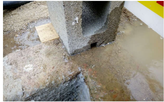
INICI VESSAMENT A L'EXTERIOR CANTONADA BAIXA (ZONA 4) 12:33 h
