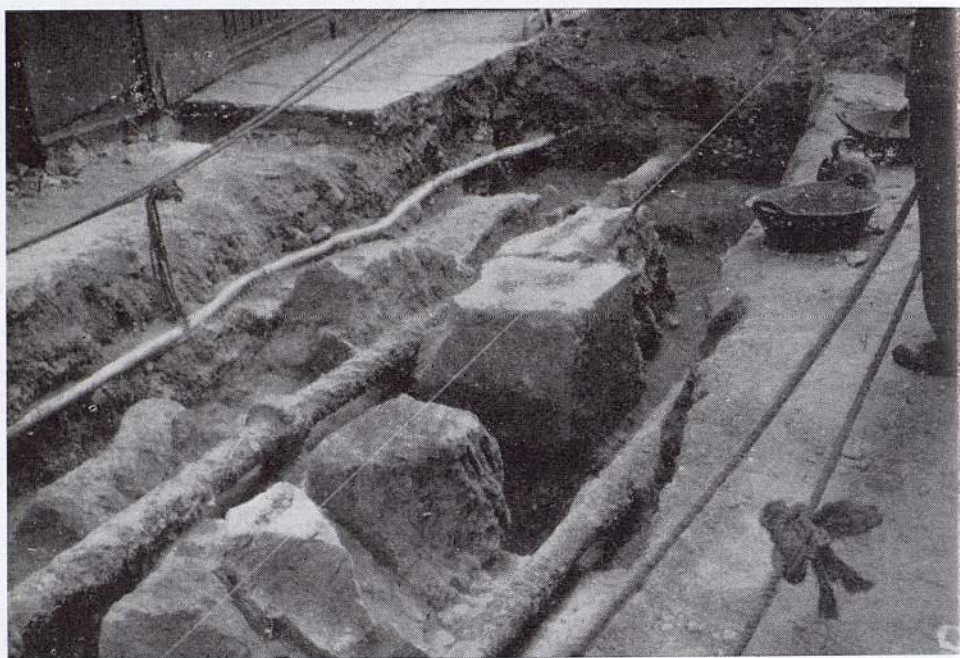
Excavaciones en la Bajada de la Cárcel (hoy calle de la Librería)
