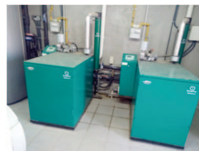
Calderes de cogeneració
