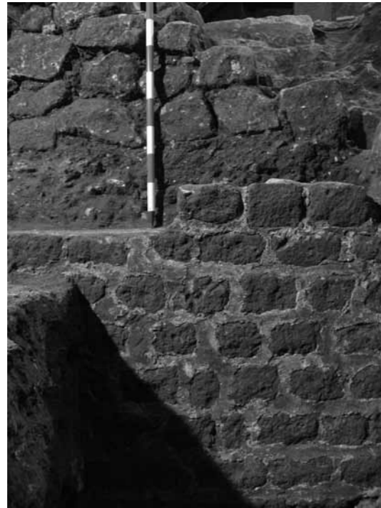
Detall de la fàbrica dels dos tipus de murs. A la part inferior es pot veure l'acabat del mur altimperial.
