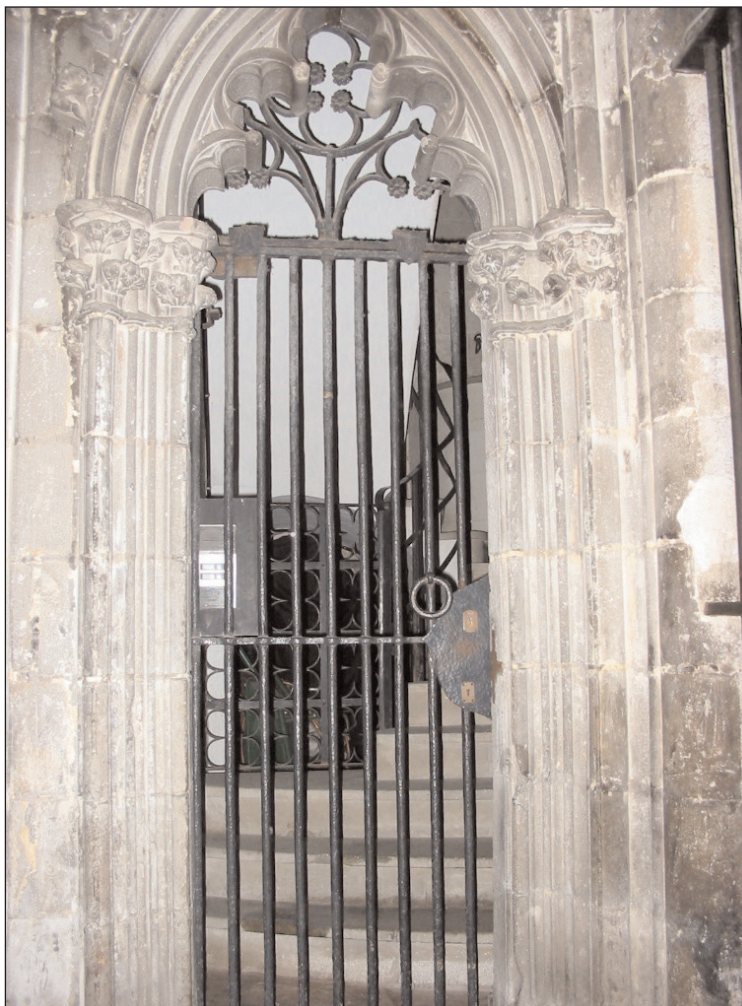
Figura 1. Imatge genèrica de la reixa de l'accés a l'escala del terrat del claustre
