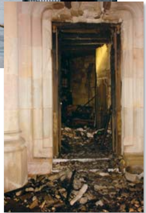
▲ Els equips de Bombers a l'entrada de la cripta de la Sagrada Família, durant l'incendi del passat 19 d'abril. A sota, l'estat en què va quedar la sagristia
