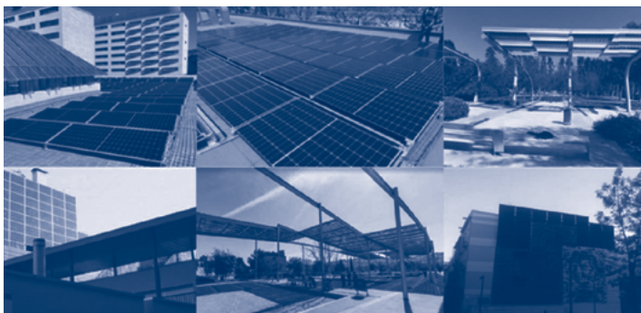
Imatge 1. Instal·lacions fotovoltaïques en edificis municipals
