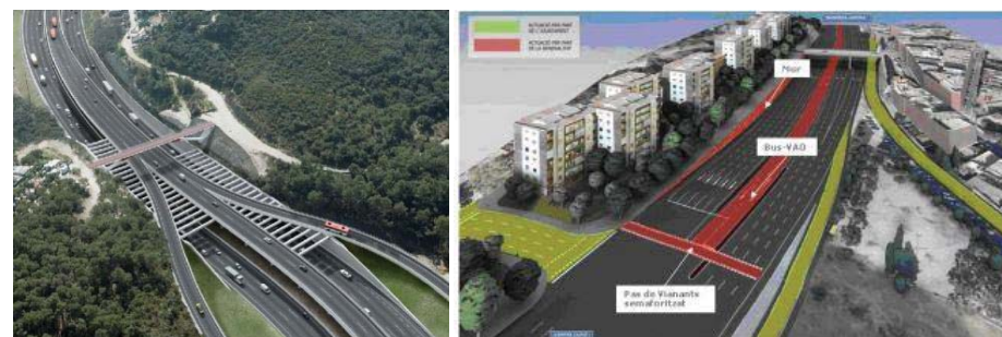
Carril BUS-VAO en construcció al corredor del Vallès (C-58) entre Meridiana y Ripollet Font: PEMB
