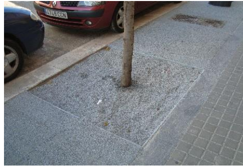
Imatge 26. Escocell i a la dreta embornal sobreeixidor a Torre Baró
