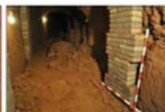
11. Desprésaments pareds i pilar caigut
