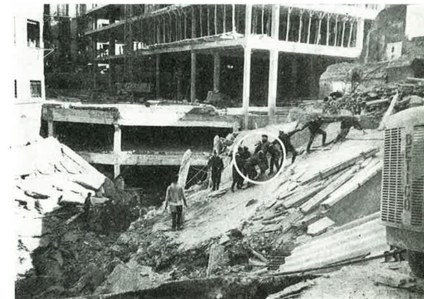
A primeras horas de la mañana del día 27 de marzo se derrumbó en Madrid un aparcamiento subterráneo de coches en el que se hallaban trabajando unos cincuenta obreros. Hubo que lamentar un muerto y varios heridos. (Foto Europa Press)
