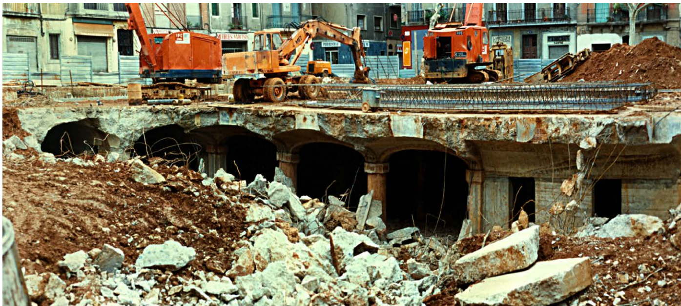
Enderroc del refugi construït a la plaça del Sol durant la Guerra Civil a principi de la dècada de 1980. AUTOR DESCONEGUT/ALBERDI
