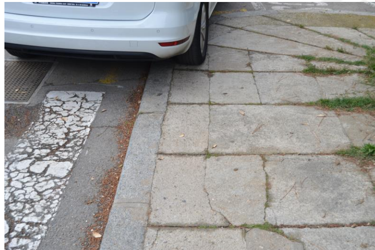
Peces de paviment trencades.
