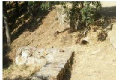
Murets difusos existents que no funcionen correctament.
