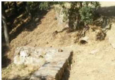
Murets difusors existents que no funcionen correctament.
