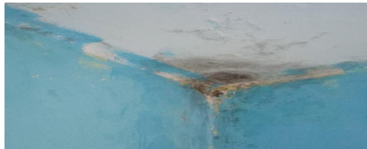
Fig. 4.3-24: Filtració en un sostre sota coberta
