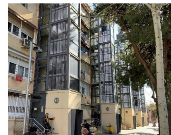
Fig. 5.3-5: Ascensor instal·lat en bloc de tipologia A
