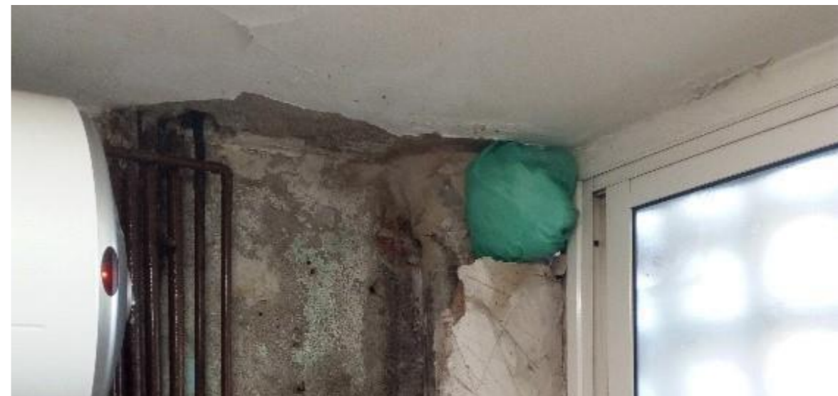
Fig. 4.3-26: Humitats i desprendiments en instal·lacions dins d'un safareig
