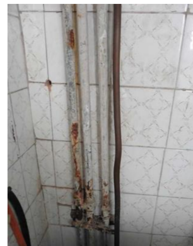
Fig. 4.3-27: Oxidació i corrosió en conductes
