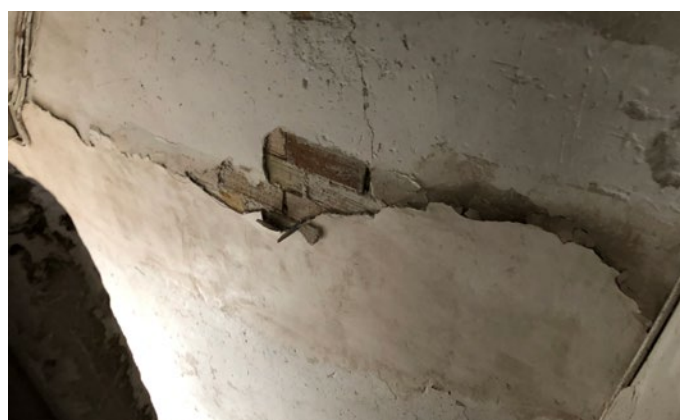
Estado antes de la intervención del IMU
