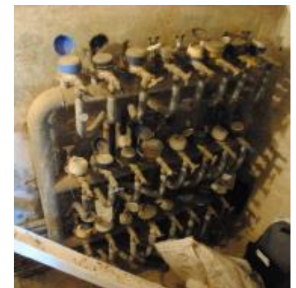
Centralització de comptadors d'AS
