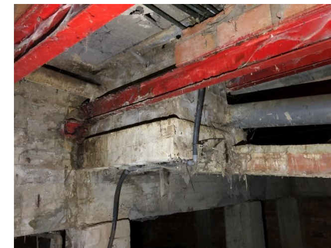
vista del reforç a la cambra sanitària i de la xarxa de sanejament
