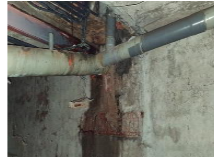
vista del reforç a la cambra sanitària i de la xarxa de sanejament
