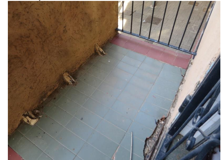
Detall de l'estat del paviment al balcó 1er pis
