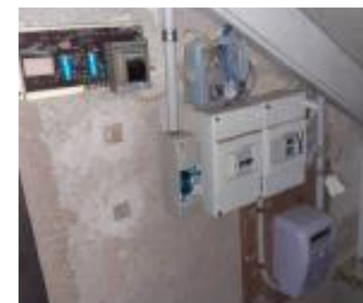
Instal·lacions elèctriques comunitàries
