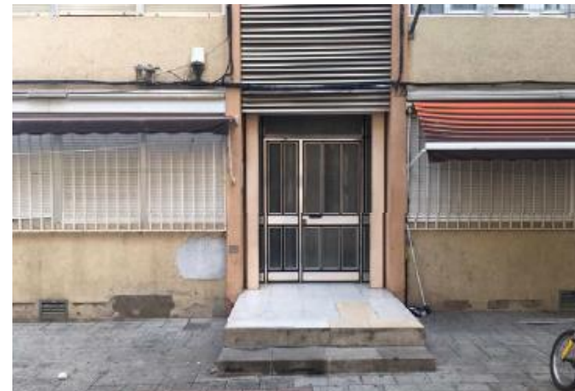
Desnivell a l'accés al bloc de Prada 12.
