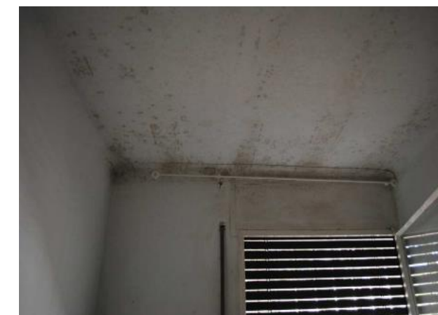
Presencial de condensacions en els interiors dels habitatges
