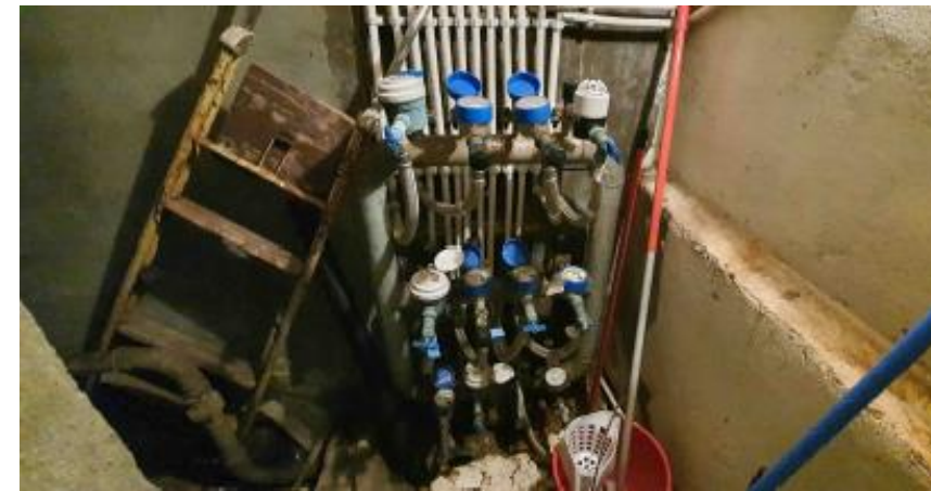
Bateria de comptadors d'aigua
