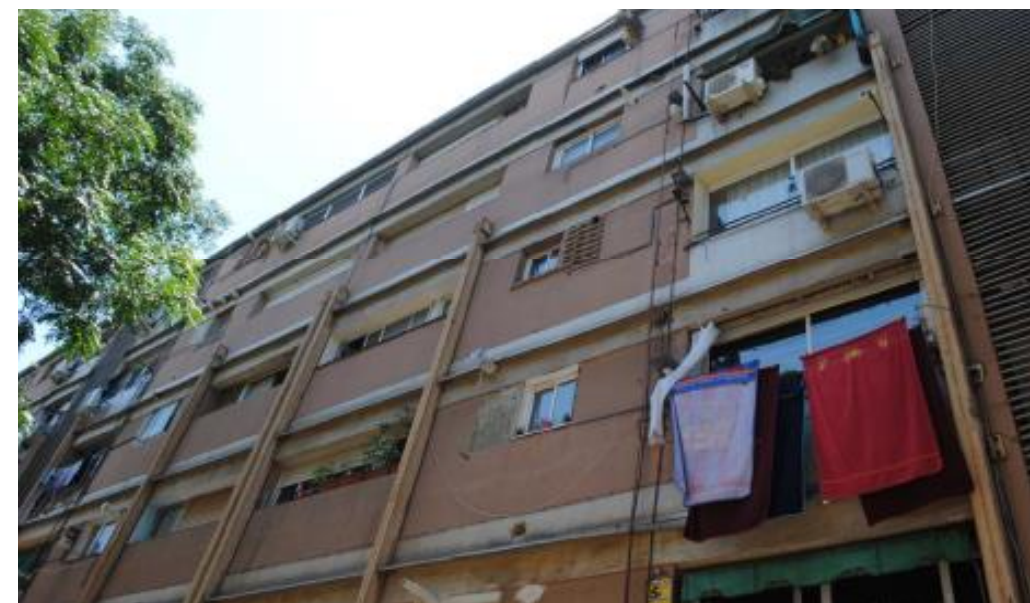
Mostres de desprendiments de la Façana del c. Teulada
