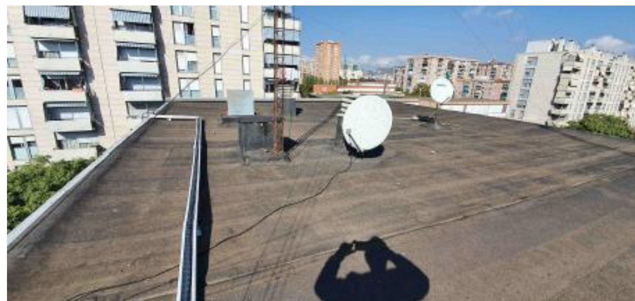
Instal·lacions a coberta
