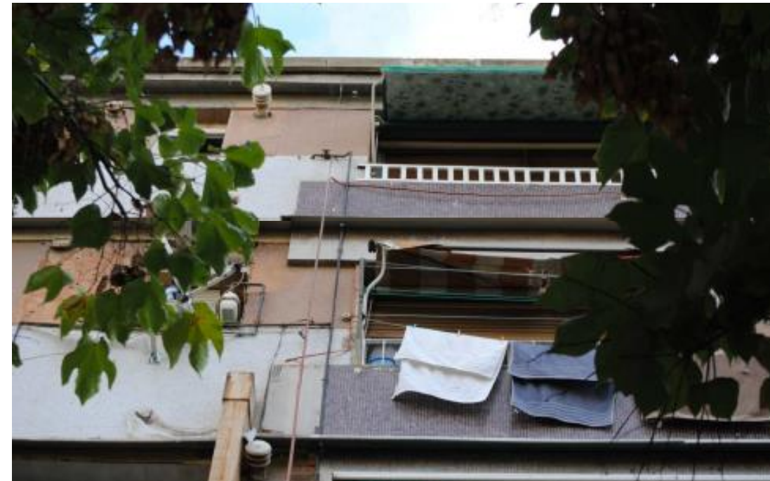
Passos d'instal·lacions i tub de ventilació a façana del c. Alfons el Magnànim
