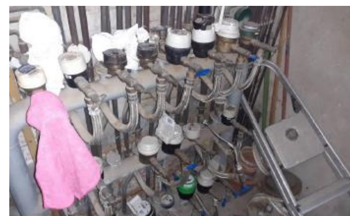
Centralització de comptadors d'AS
