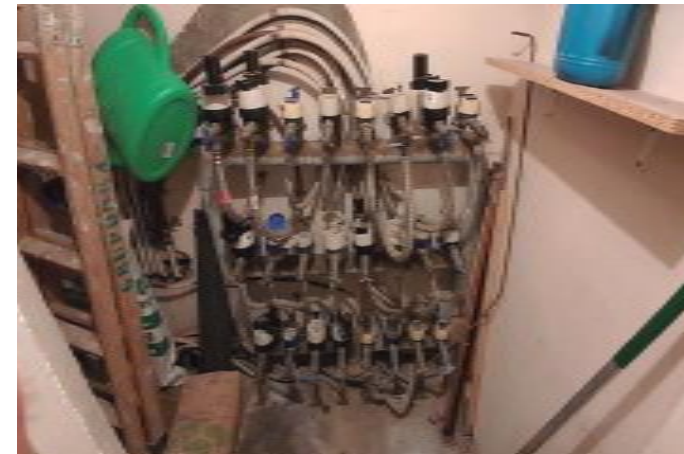
Centralització de comptadors d'AS
