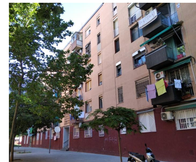
Aparells de consoles d'aire condicionat a façana
