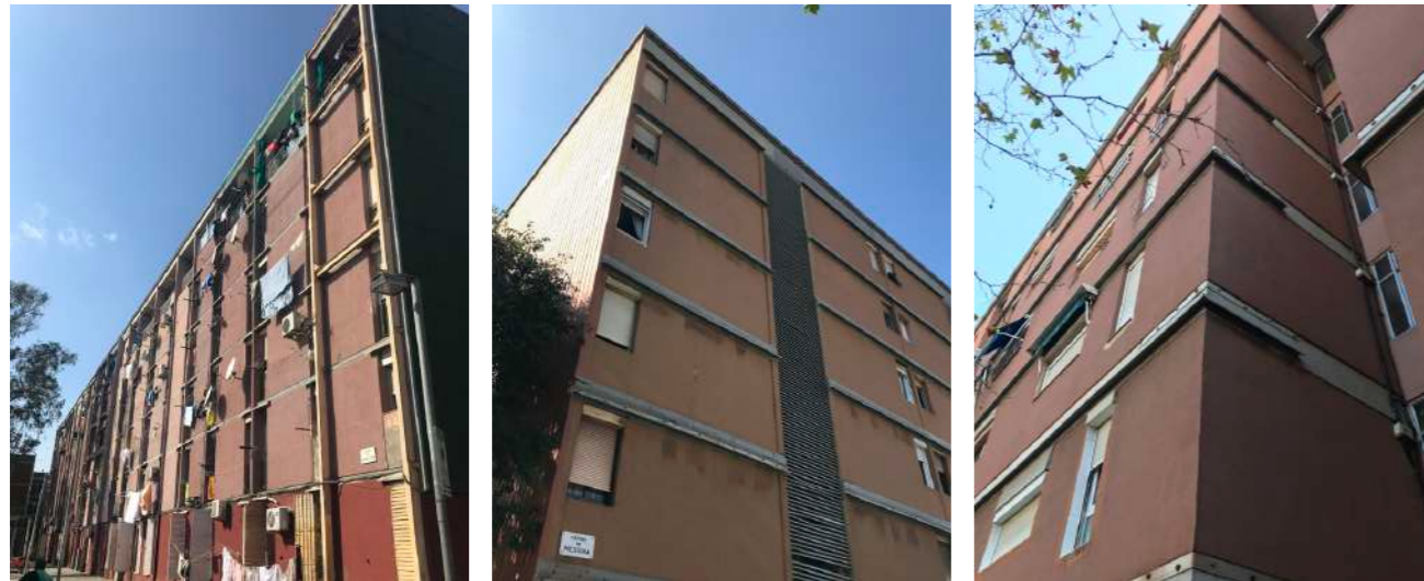
fig 03: Blocs J, K i L amb reforços estructurals en façana
