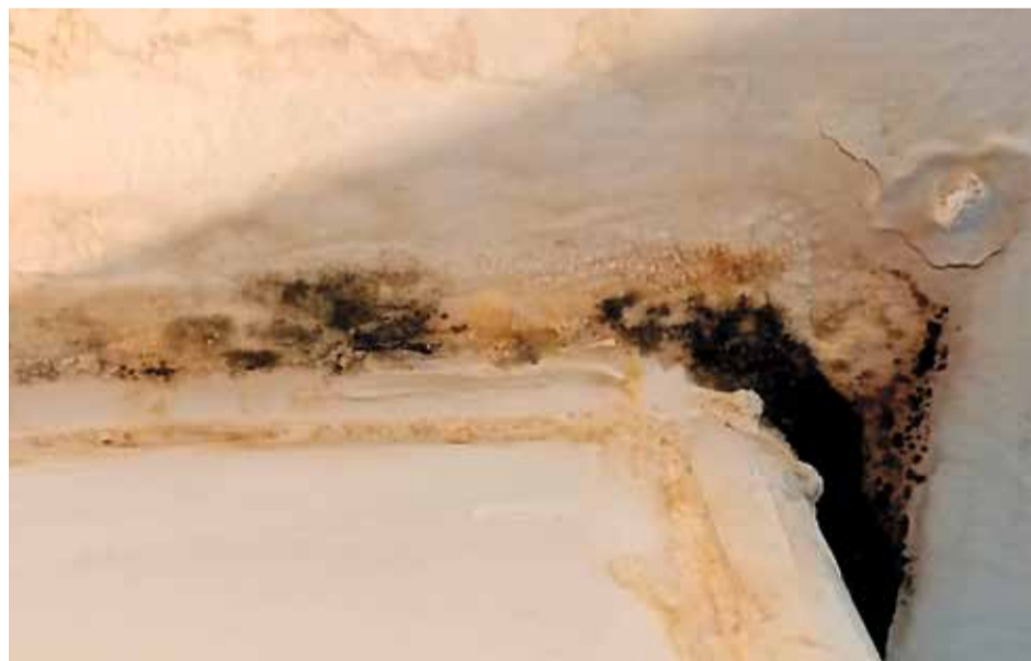
► Les humitats s'agregen i s'estenen arreu de l'edifici.
