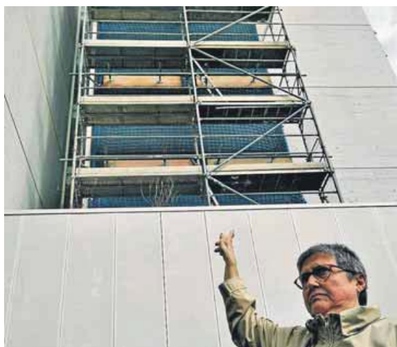
La Carmen Redondo assenyalant una de les bastides que apuntalen la façana de l'edifici on viu i del qual és presidenta de la comunitat de propietari ■
