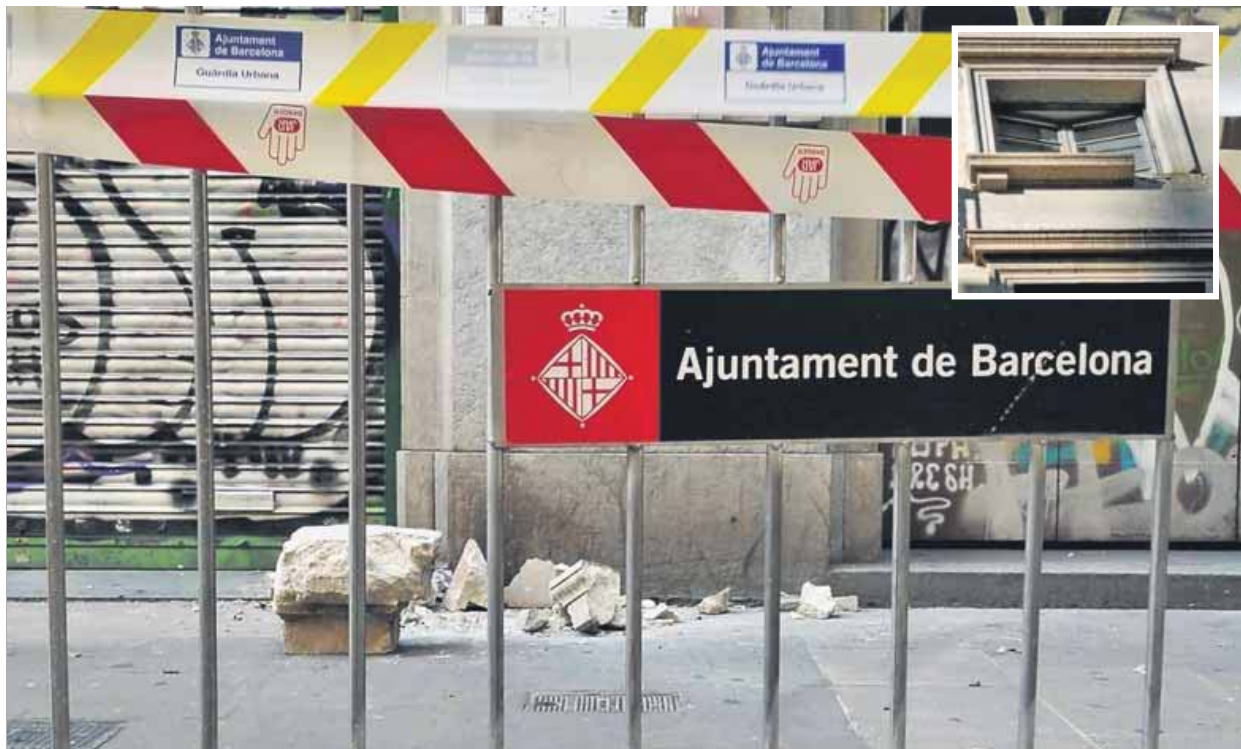
Les pedres que van caure de la façana del Casal del Metge, el 4 de març passat, i la base de la finestra del tercer pis des d'on es van desprendre ■ JPF
