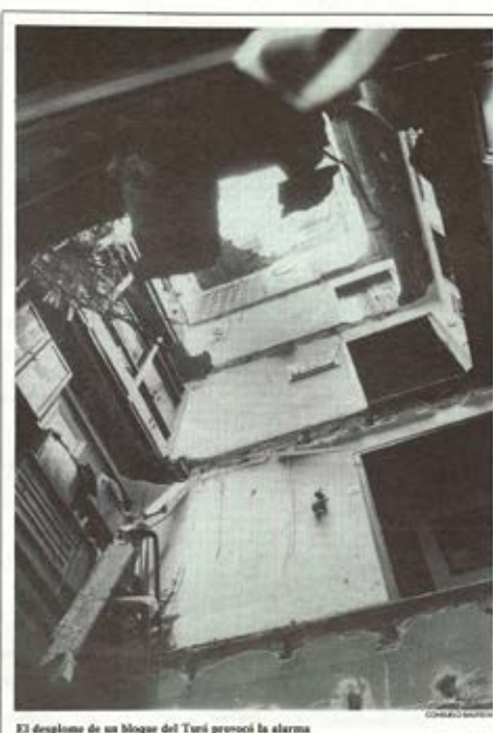
El desplome de un bloque del Turó provocó la alarma
