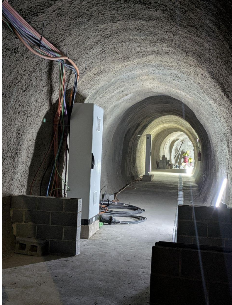
QUADRES DE CONTROL SITUATS EN GALERIES
