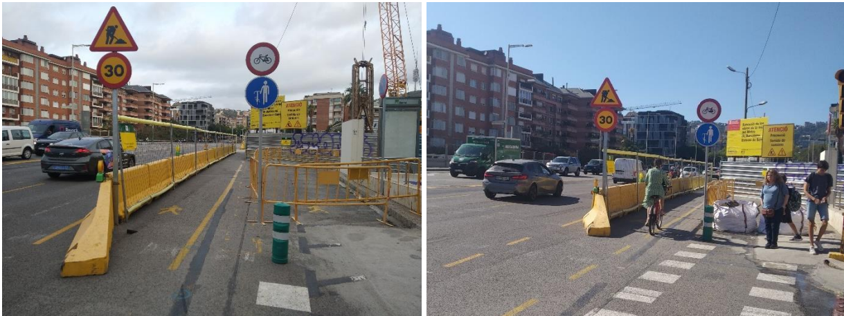
Fig. 53: Senyals en el tram d'obres (esquerra) i ciclista infringint la senyalització (dreta); Font: AIM, elaboració pròpia
