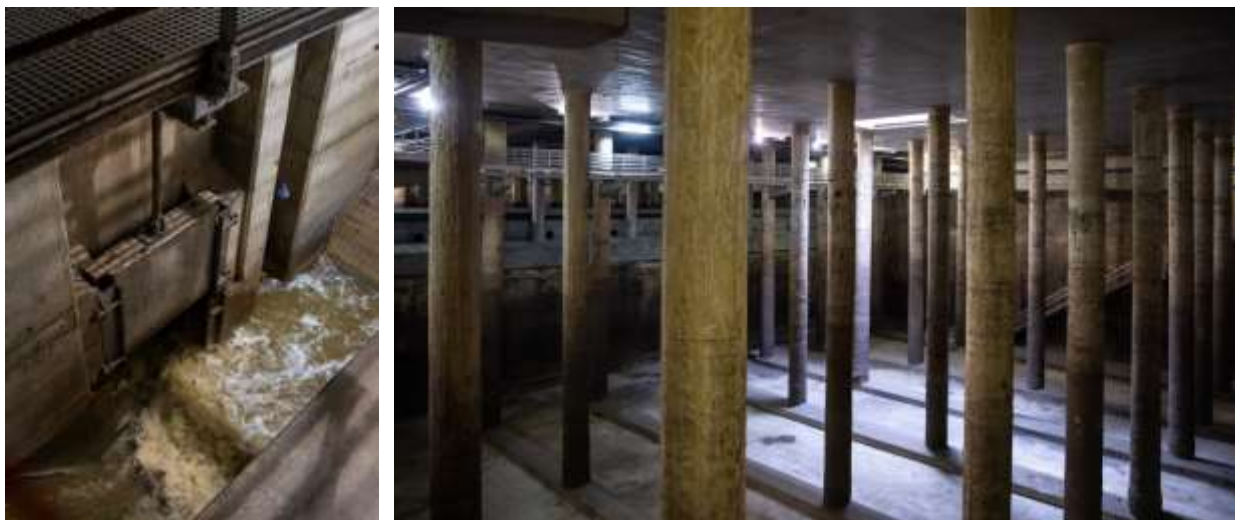
Dipòsit pluvial del parc de Joan Miró, a l'Eixample
