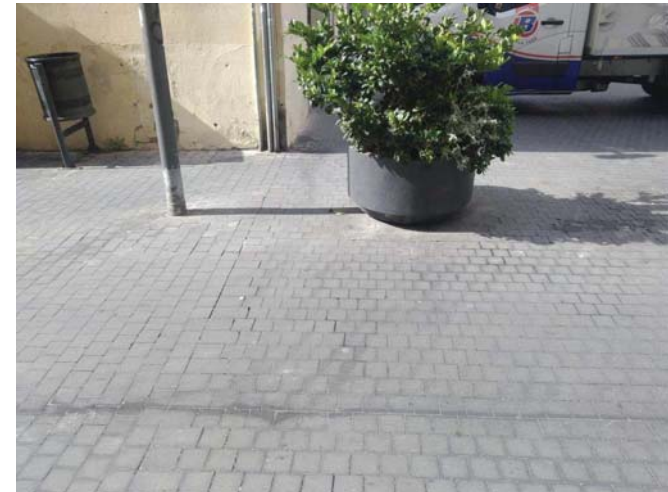
Fotografia 2: Paviment peces 10x10x10cm en mal estat
