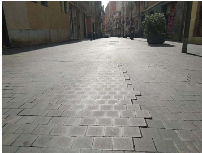
Fotografia 5: Paviment peces 10x10x10cm en mal estat
