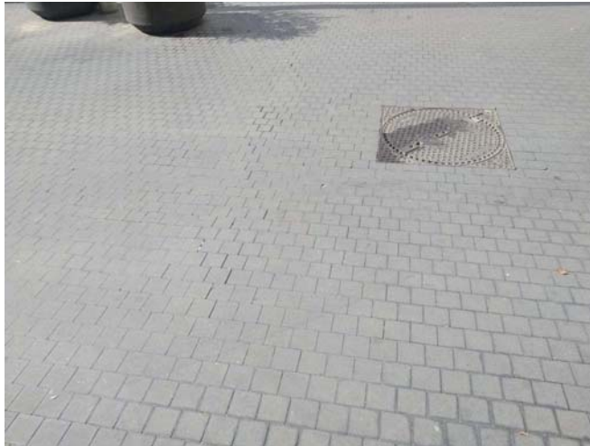
Fotografia 1: Paviment peces 10x10x10cm en mal estat
