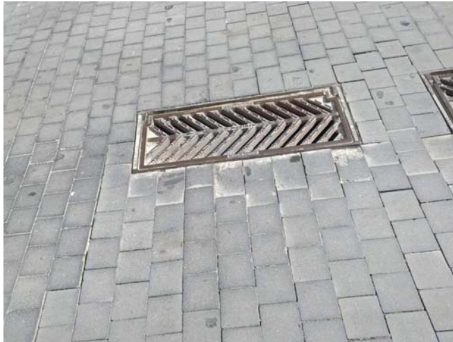
Fotografia 4: Paviment peces 10x10x10cm en mal estat i embornal
