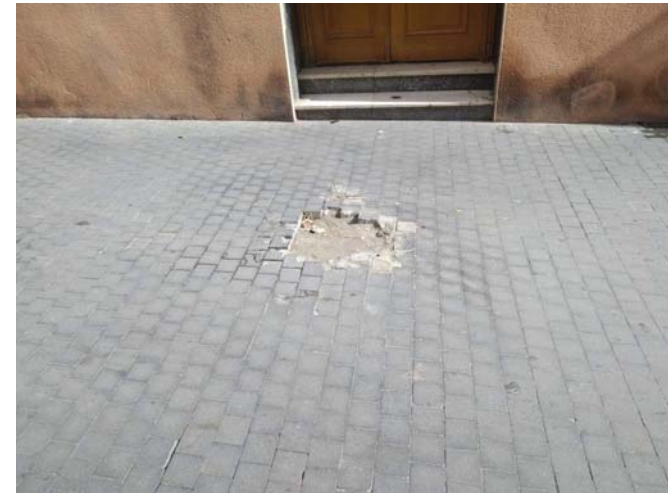
Fotografia 7: Paviment peces 10x10x10cm en mal estat
