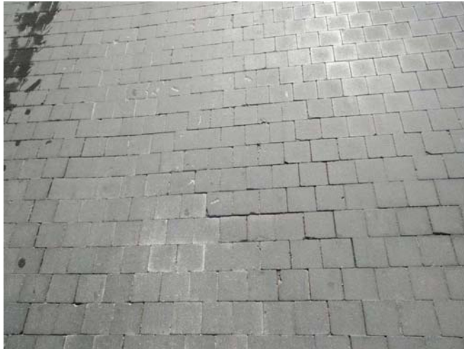
Fotografia 8: Paviment peces 10x10x10cm en mal estat
