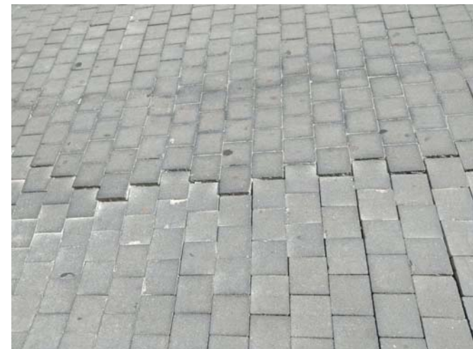
Fotografia 3: Paviment peces 10x10x10cm en mal estat
