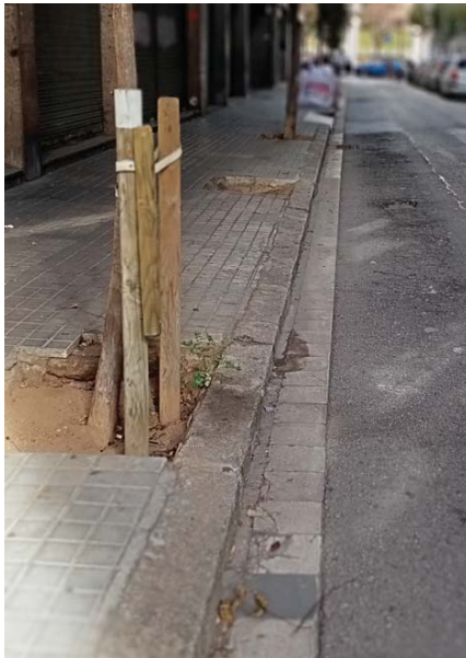
Fotografia 7: Mostra dels escocells, Alguns en mal estat inclosa la vorada i la rigola
