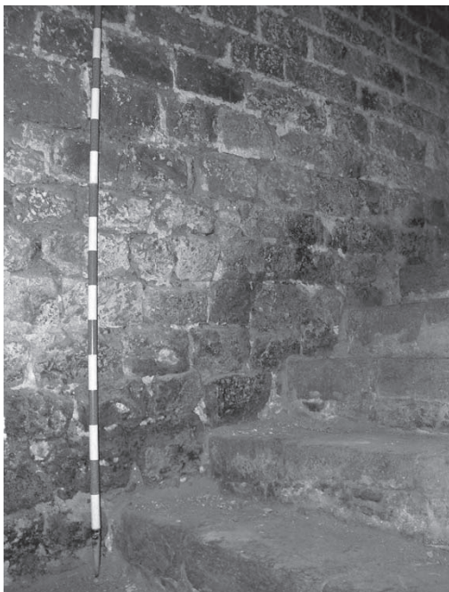
Detall d'un parament de carreus cohesionat amb morter argilós de calç (pl. Oli, núm. 4).
